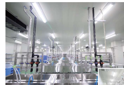
各所に配管された殺菌用の電解次亜水
