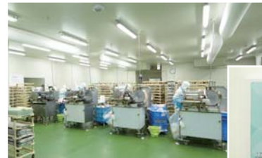
断熱パネルで構築したクリーンルーム
